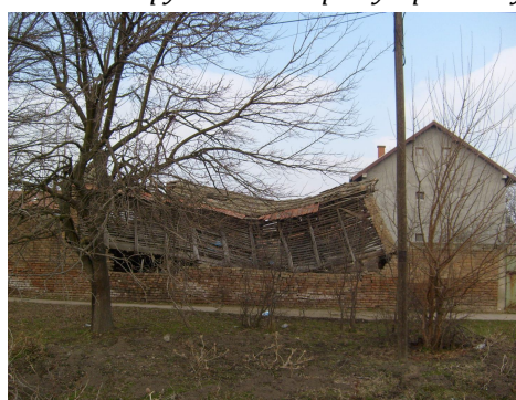
Слика 2: Срушена котарка у Орловату
